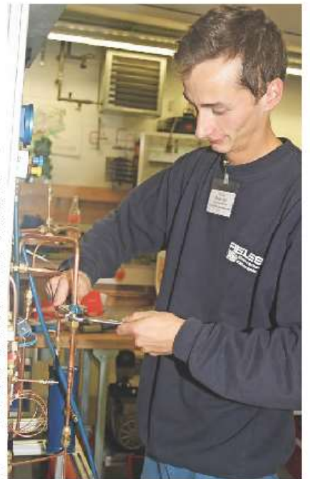
Eugen Sell (25) aus Schleswig-Holstein stöhnt. Er hätte sich gewünscht, dass die Rohre gelötet werden. Mit der Schraubbefestigung sind sie schwer dicht zu bekommen. Elektrotechnisch ist für ihn das Kälteaggregat aber keine Herausforderung. Foto: Sonja Adam
